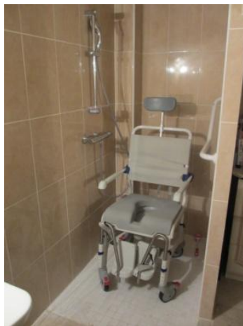
734,58 € pour l'aménagement d'une douche chez Abdelkader de St Jean de la Ruelle
